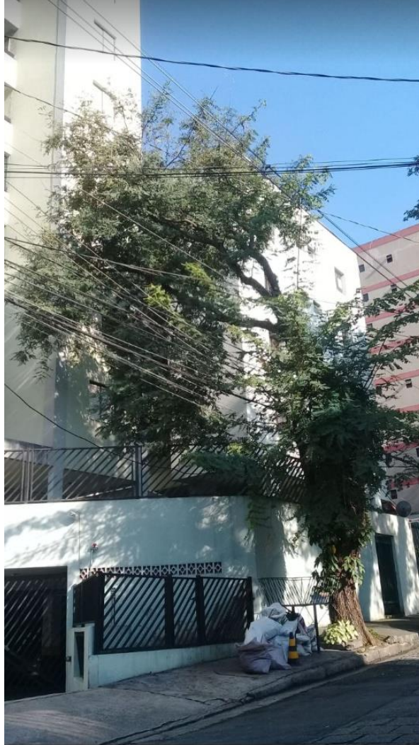
Figura 48 - Exemplar em conflito com edificação
