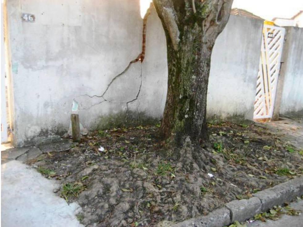
Figura 42– Ligustro ( Ligustrum lucidum W.T. Aito) em conflito com acessibilidade e edificação
