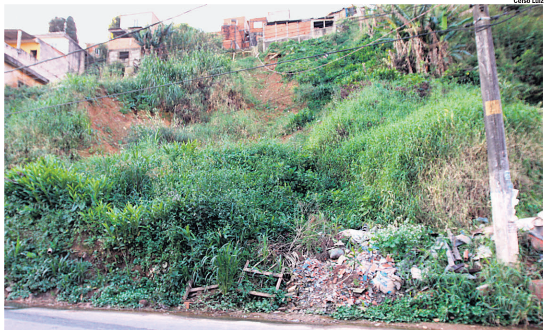
PROBLEMA. Após deslizamento de terra que interditou imóveis, risco permanece na Rua Jesus de Nazareth
