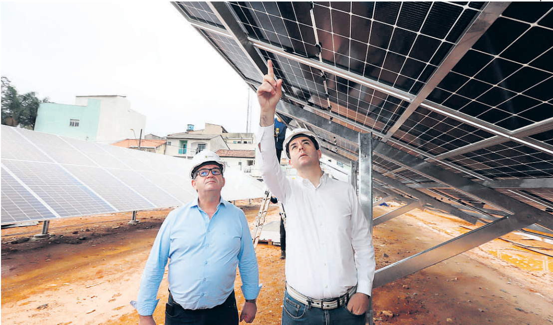
PROJEÇÃO. Usina José Marçon, no Jardim Las Vegas, terá 1.764 painéis; prefeito Paulo Serra e vice Zacarias vistoriaram obras
